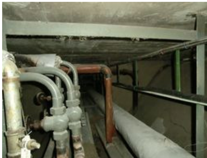
Potrubí vedená pod budovou B a C
