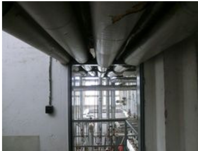
Potrubí vedená z kotelny do kolektoru
